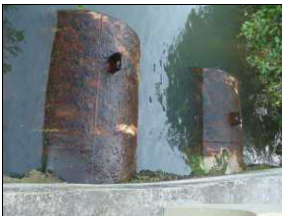
Figura 25 – “Emissários” do Canal de Drenagem Fonte: Foto do Autor – Novembro de 2012
